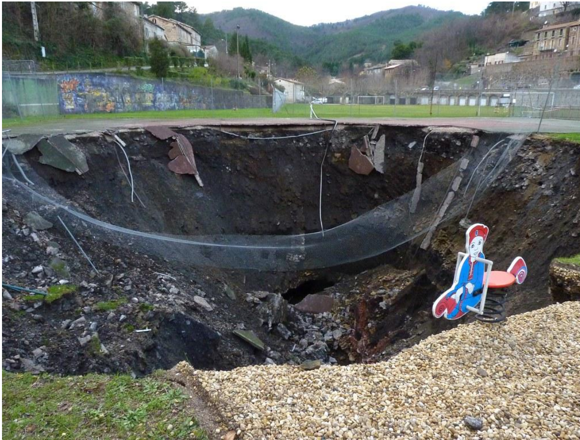
Le trou d'effondrement du tunnel du Rieusset – Rochessadoule (2012)
